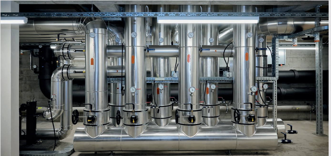
Energiezentrale Haberfeld, Vaduz (Fernwärme-Verteiler)
