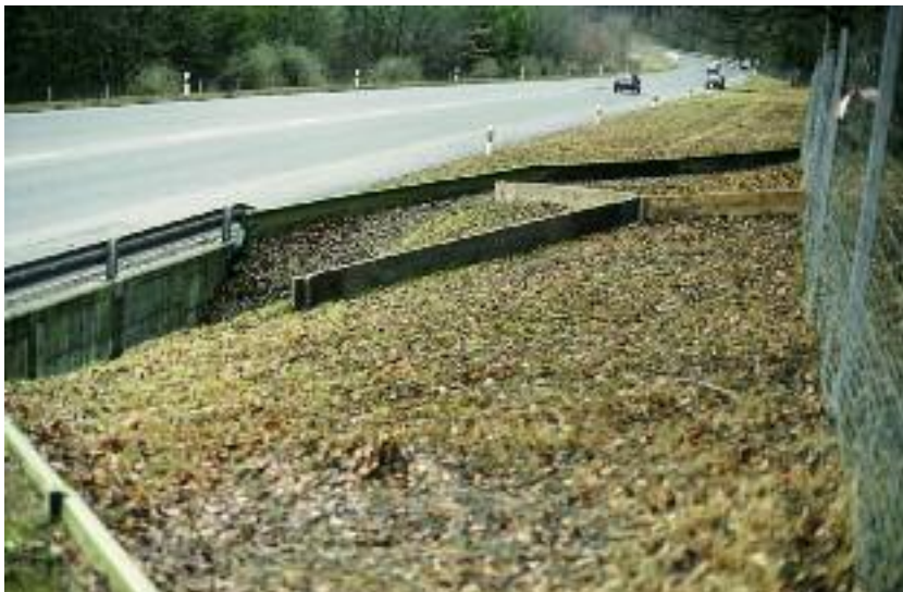
Abb. 58: Heutige Situation 2002: Wildzaun mit engmaschigem 40 cm hohen Amphibiennetz und trichterförmigen Leitelementen zu den Durchlässen.
