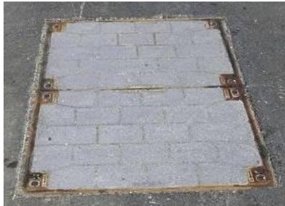
Abbildung 6 Kabelkanalisation: Einstiegschacht Ansicht oben
