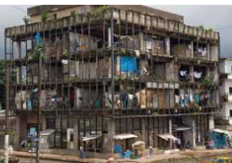
Verlassenes Bürogebäude in Monrovia, bewohnt von Binnenvertriebenen, die im urbanen Raum leben
